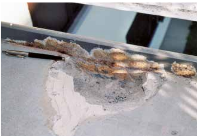
I fenomeni di corrosione sono limitati all'area di contatto fra le piastrelle e la struttura in acciaio.
