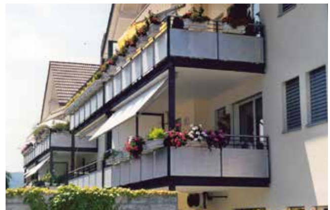
Die Korrosionserscheinungen treten typischerweise ein bis zwei Jahre nach Fertigstellung des Bauwerks auf. Soprattutto negli ambienti esterni vi è un elevato rischio che si producano dei danni.
