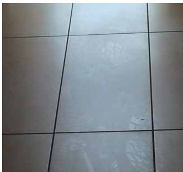
Putzmittelrückstände (Pflegefilm), betreten mit feuchten und nassen Schuhen.
