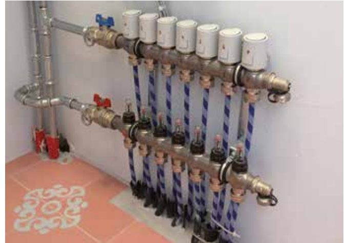
Heizkreisverteiler mit Stellantrieben und Basiseinheit
